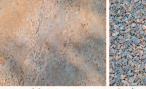
कर घटिया स्तर का सीसी सड़क निर्माण किए जाने का आरोप भी लगाया जा रहा है। ग्रामीणों के द्वारा बताया गया की सीसी सड़क निर्माण कार्य से पूर्व बिना बेस के ही सीधे जीरा और 20 एमएम की गिट्टी से कहीं 2 इंच कहीं 4 इंच ढलाई कर सीसी सड़क निर्माण किया जा रहा है। ग्रामीणों ने यह भी आरोप लगाया कि एस्टीमेट के
